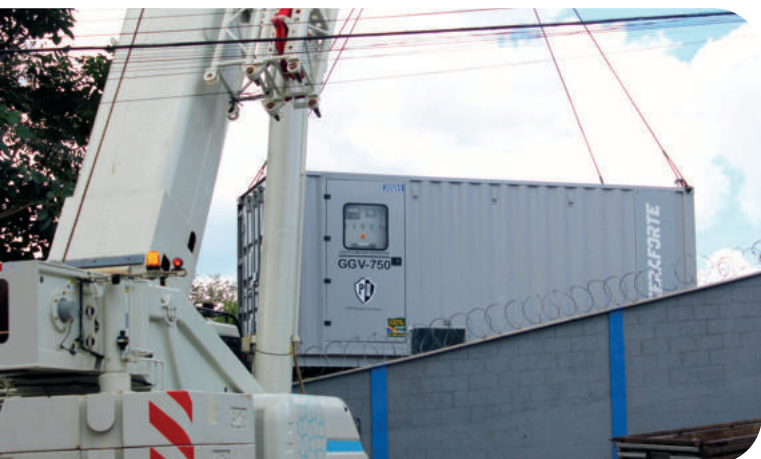
Aquisição de novo gerador garante mais economia de energia em horários de pico
